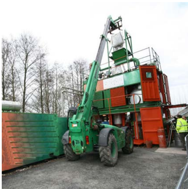
Plnenie 1 MW modulu
